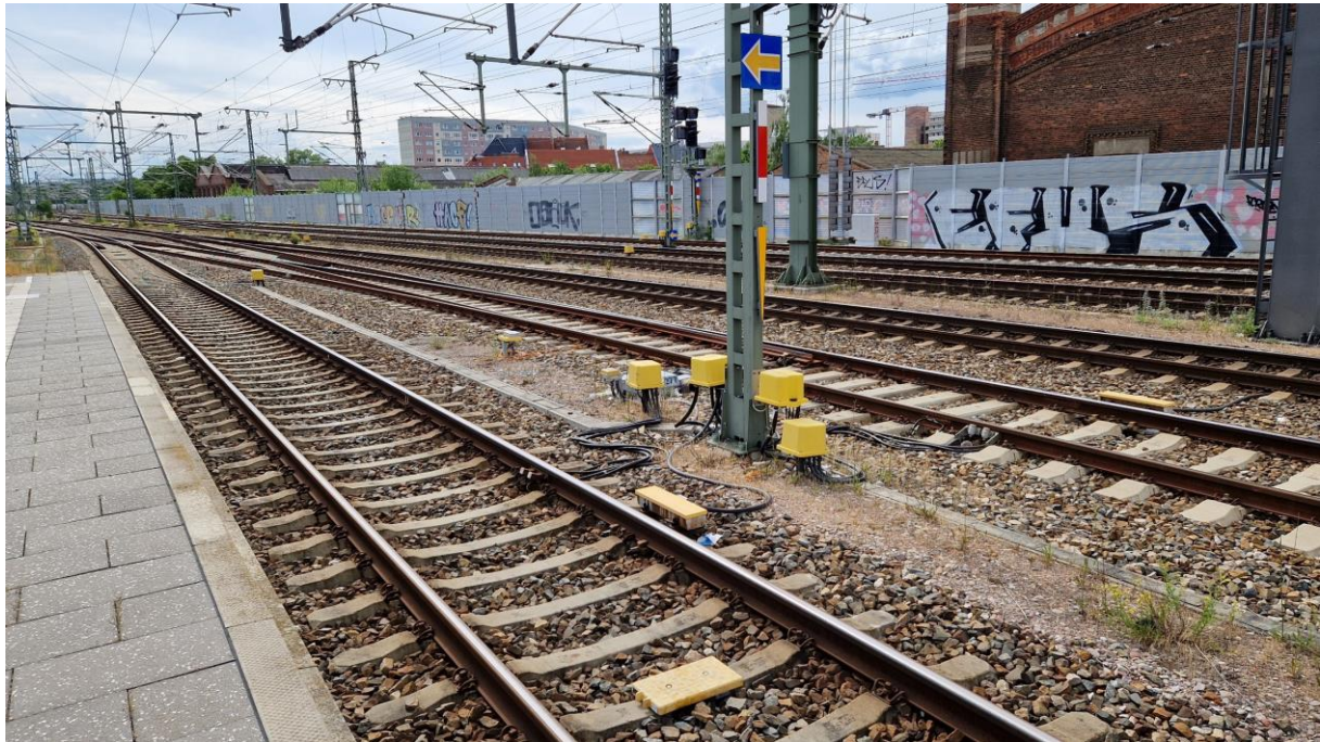
Abbildung 2-8: Streckenausrüstung im Erfurter Hauptbahnhof für ETCS Level 2 mit Signalen in Kombination mit PZB-Ausrüstung
