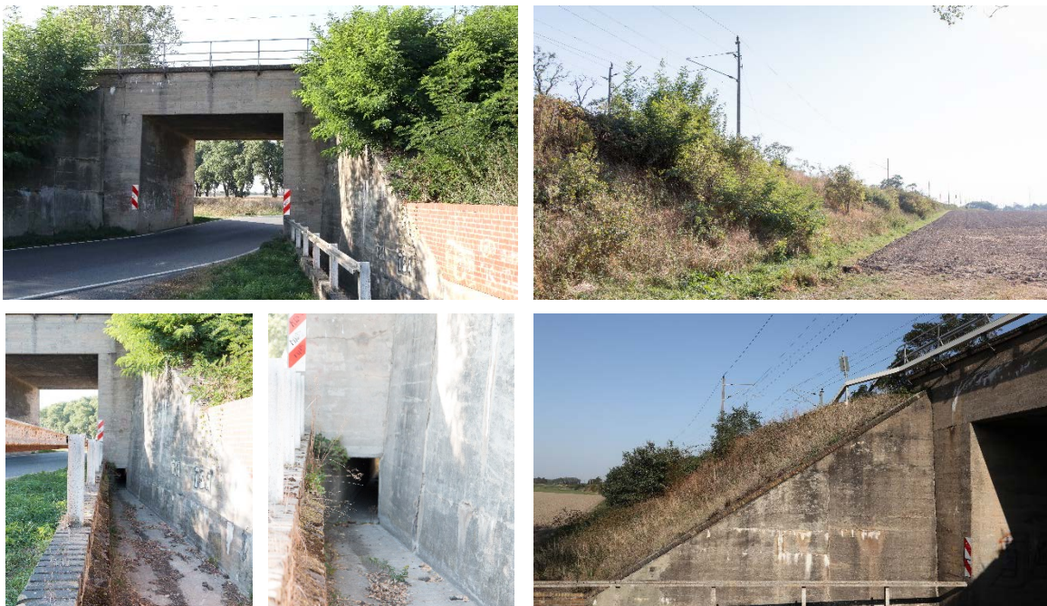
Abbildung 13.24: Niveaufreie Kreuzung der Strecke 6360 mit dem Gallener Weg bei Jesewitz (Eigene Aufnahmen)
