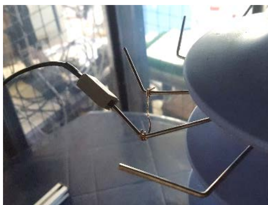
Abbildung 7: Galvanische Verbindung mittels Kupferleiter an KTA-Abweiserstacheln
